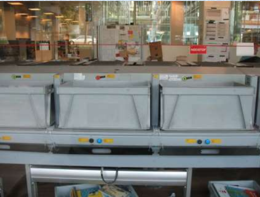
Taśmociąg segregujący zwroty
